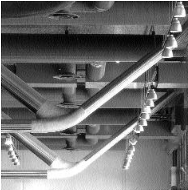
A belső térben láthatóak a gépészeti berendezések és a tűzvédelmi burkolattal ellátott rácsostartók.
